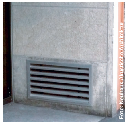
Die Bauweise und Platzierung von technischen Anlagen haben grossen Einfluss auf die Geräuschentwicklung und damit auf das Störpotenzial in der Umgebung.
